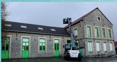
La tempête aura causé plusieurs dégâts, notamment au niveau des toitures.
